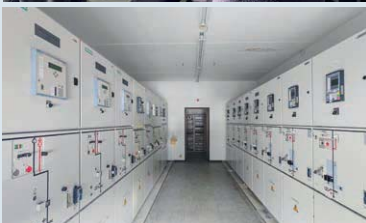
Ein Blick hinter die Kulissen im Umspannwerk Judenburg.
